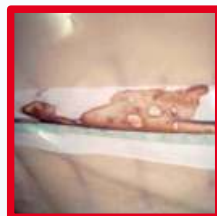
zawilgocona folia paroizolacyjna
