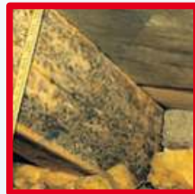
zagrzybiona drewniana konstrukcja dachu
